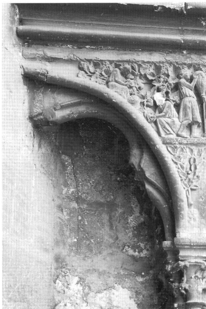
Fig. 230. Bourges, Saint-Étienne, façade occidentale, ébrasement droit du portail Saint-Ursin, détail.
